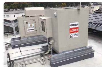
屋上に整備された非常時の発電機
