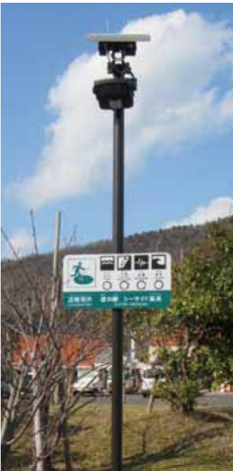
道の駅「シーサイド高浜」に設置された 避難所施設誘導用LED灯▼
