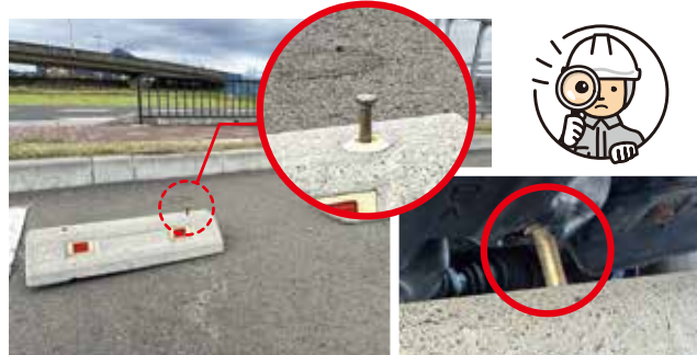
自動車に接触したアンカーピン
