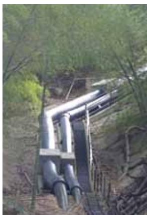
配水池への送水管
