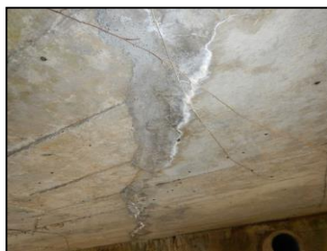
■ コンクリートのひびわれ
