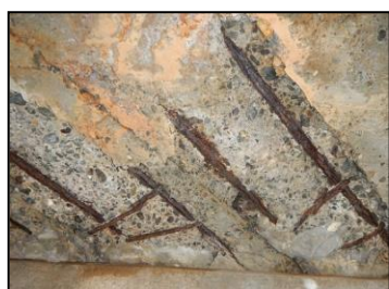
■ コンクリートの落下
