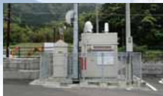
福井県環境放射線監視 テレメータシステム(三松観測局)
