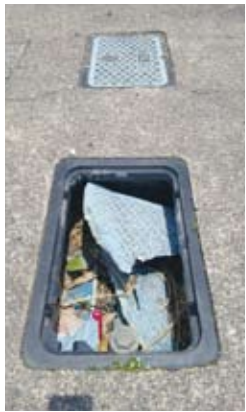
破損した水道メーターの蓋
