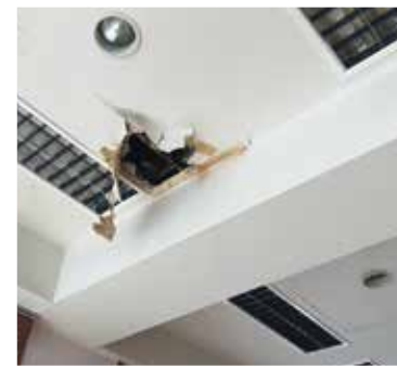
高浜児童センター 雨漏り箇所
