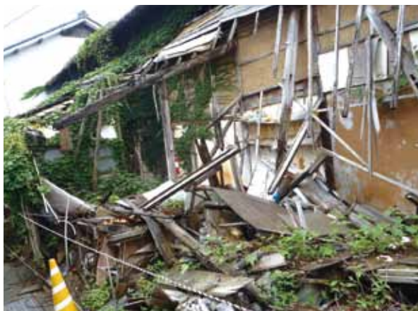
町内の老朽危険空き家
