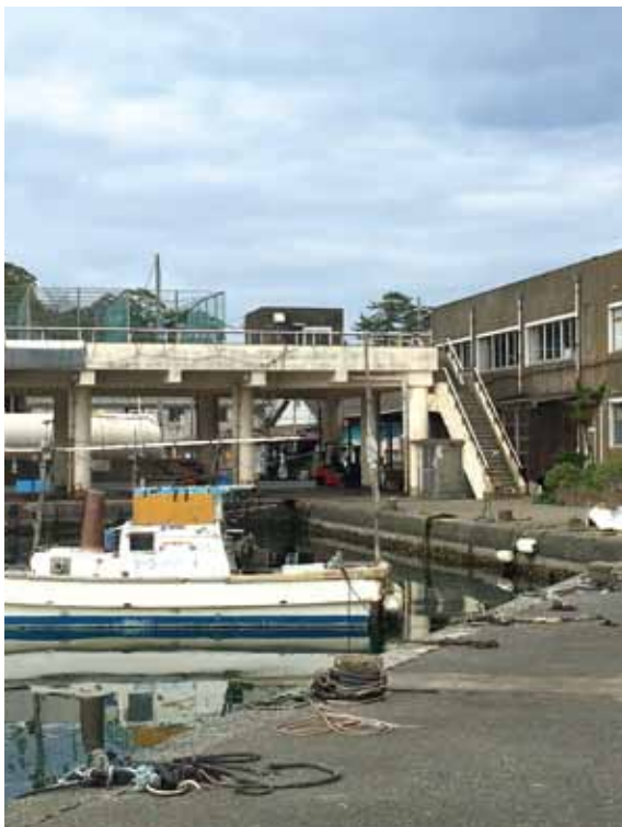
老朽化が進む高浜漁港本所と荷捌き場
