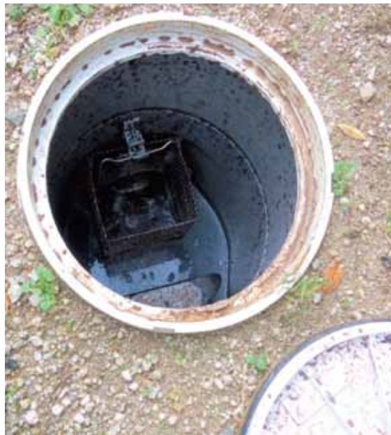
下水道分離マス
