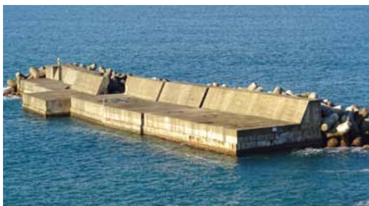
沖防波堤の被害状況
