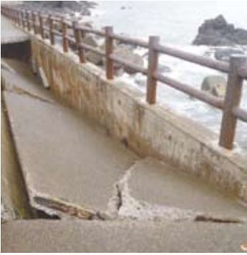
脇坂公園遊歩道破損現場
